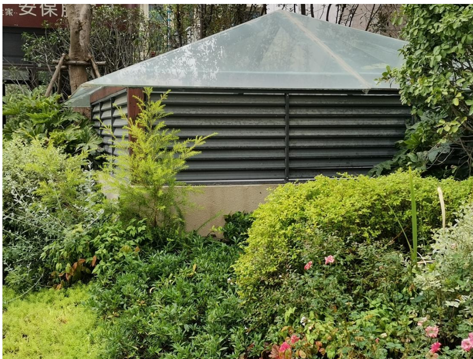
地下车库通风竖井
